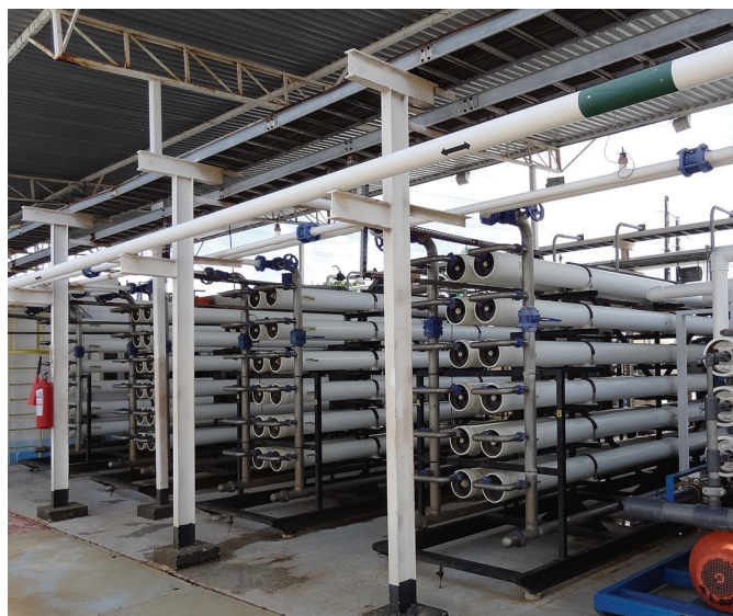
Sistema de Osmose Reversa
