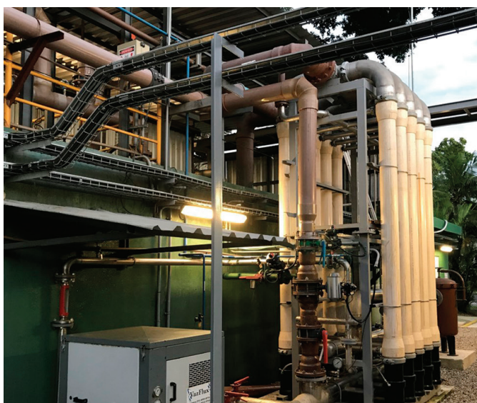
Sistema de Reúso com Ultrafiltração
