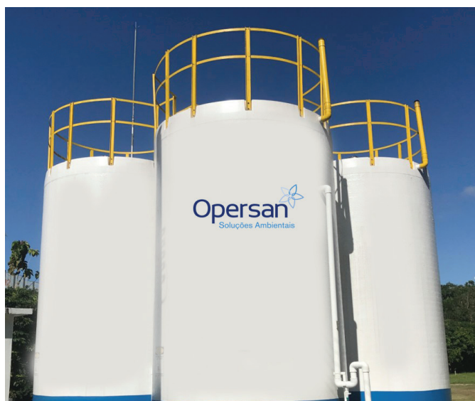
Sistema de Tratamento Anaeróbio
