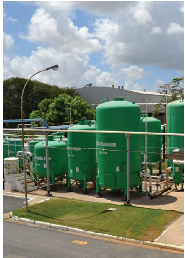
Sistema de Tratamento de Água
